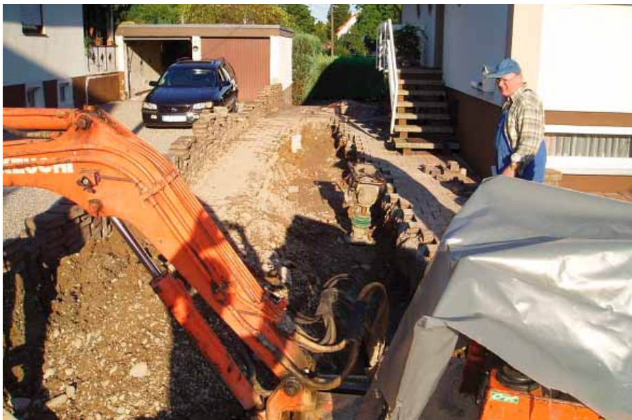
Die Sanierung der Entwässerungsanlagen auf den privaten Grundstücken ist für die Eigentümer zum Teil mit erheblichem Aufwand verbunden. Dennoch liegt Akzeptanz des Fremdwasserbeseitigungskonzeptes bei den mittlerweile etwa 700 betroffenen Grundstückseigentümern bei nahezu 100 Prozent.
