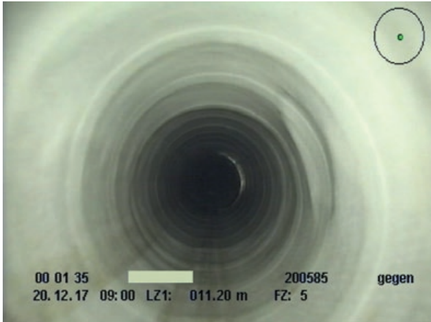
Abb. 11 – An verschlossenem Zulauf eng anliegender Liner
