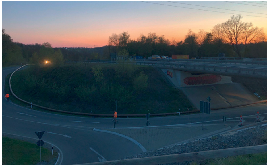
Transport PE RC-Rohrstrang zur Einzugsbaugrube am Böschungsfuß der Bundesstraße B14 | Foto: Markus Dohmann
