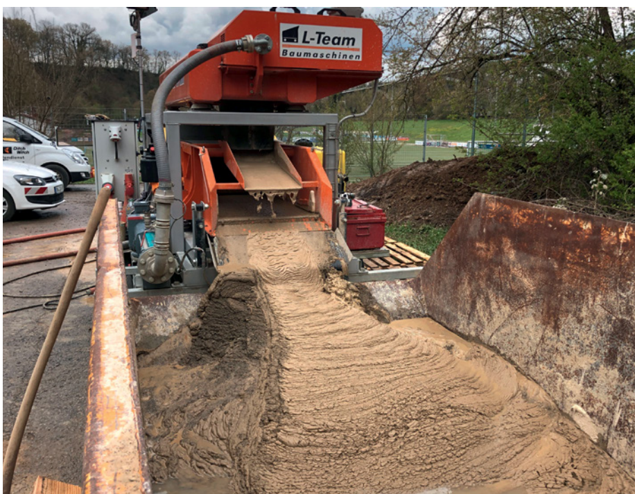
Einsatz der Separationsanlage | Foto: Markus Dohmann
